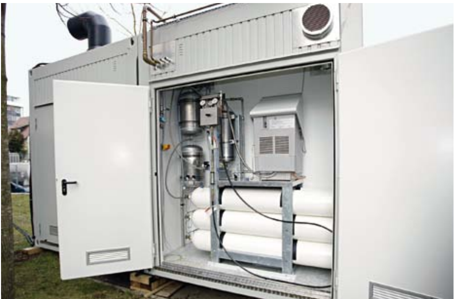
Power-to-Gas-Demonstrationsanlage des ZSW
