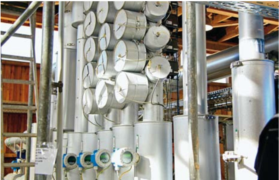
Probekammern an der Korrosionsteststrecke in Groß Schönebeck
