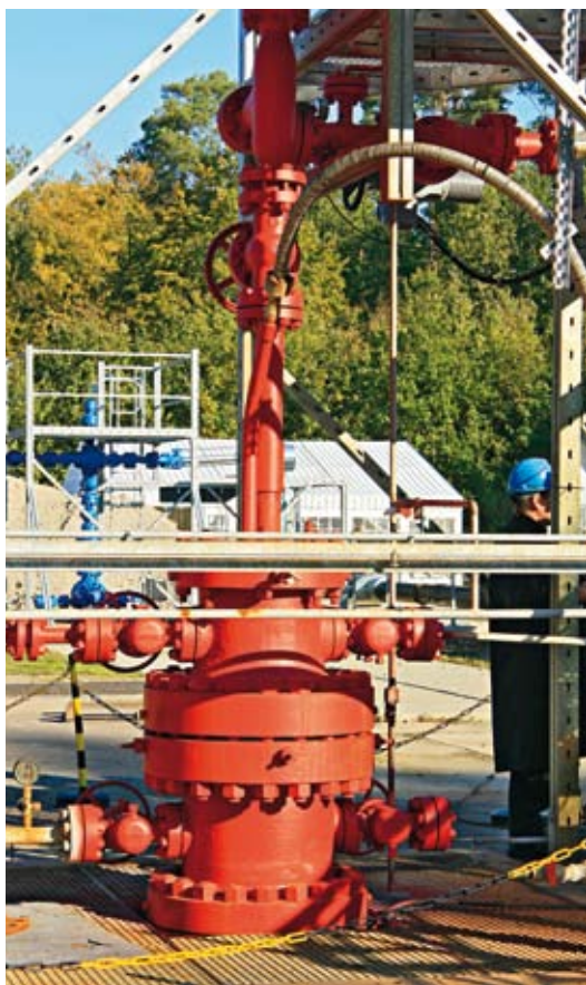
Dubletten-Bohrung der Forschungsanlage Groß Schönebeck, Norddeutsches Becken
