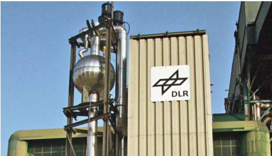
Hochtemperatur-Latentwärmespeicher der Pilotanlage aus dem Projekt ITES in Carboneras, Spanien
