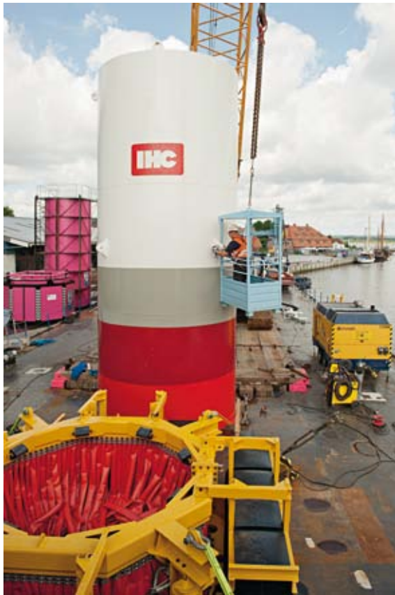
Schalldämpfungssysteme vor dem Test: Feuerwehrschauchsystem (vorne links), Noise Mitigation Screen (dahinter) und BEKA-Schale (im Hintergrund, pink)
